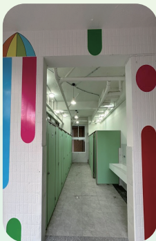
敬業樓西邊1樓 性別友善廁所
